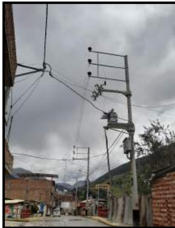
Imagen N° 24: Sistema eléctrico existente solo falta la colección
