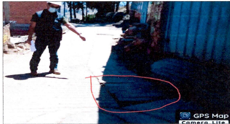
FOTO N°09. Falta de instalación de las rejillas metálicas afecta la seguridad de los usuarios.
