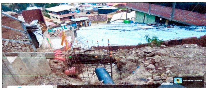
FOTO N°07. Trabajos inconclusos en la cámara de reunión.
