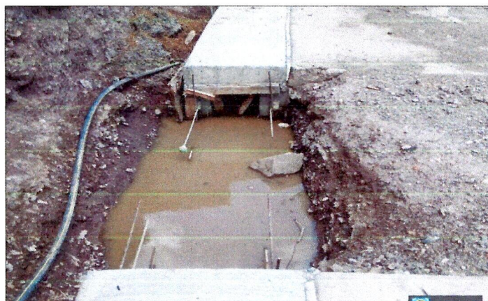
FOTO N°02. Saturación de cunetas y acero expuesto Huaripampa Alto.
