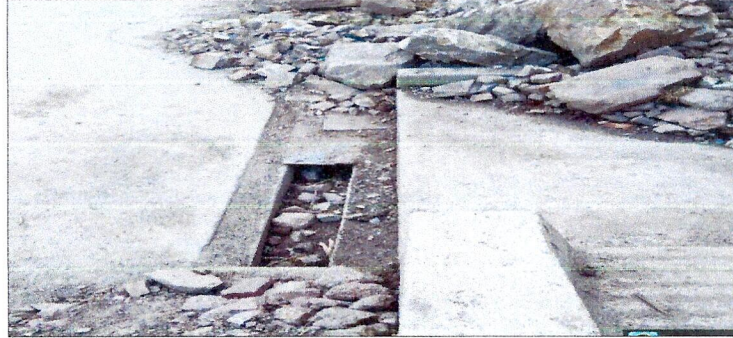
FOTO N°08. Obstrucción de cunetas por falta de instalación de rejillas metálicas.
