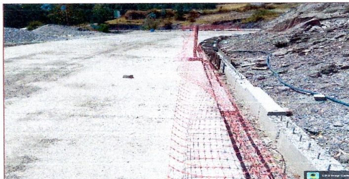
FOTO N°05. Trabajos inconclusos de encofrado y concreto en tapas de cunetas.
