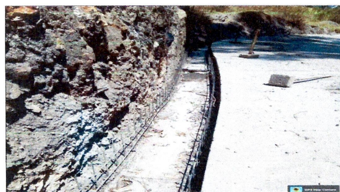
FOTO N°04. Acero expuesto de las paredes laterales de las cunetas Huaripampa Medio.
