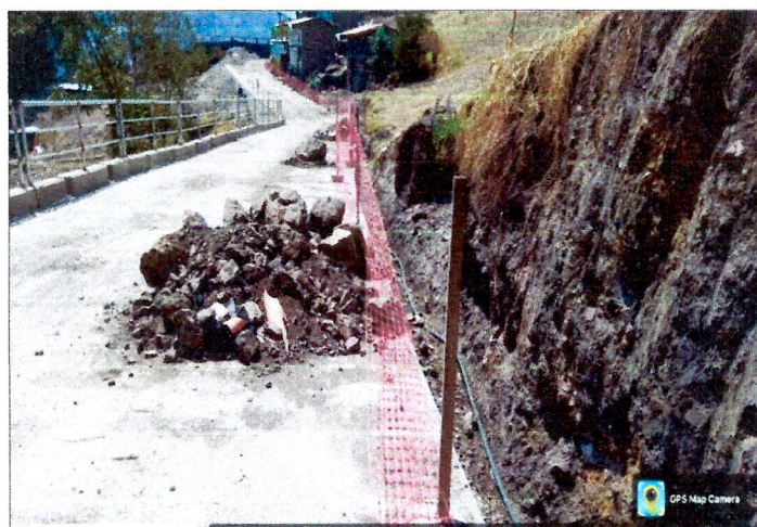
FOTO N°03. Material excedente que interrumpe el tránsito peatonal y vehicular.
