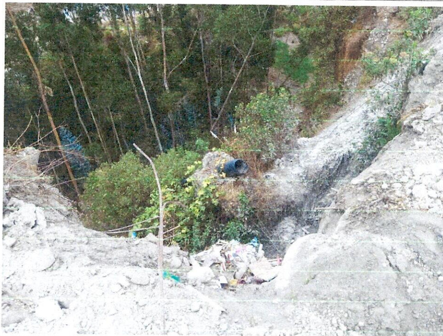
Fotografía 03: Las aguas pluviales recolectadas en toda la calle principal del barrio La Florida vienen dañando aún más el talud donde ocurrió el derrumbe del muro de gaviones.
