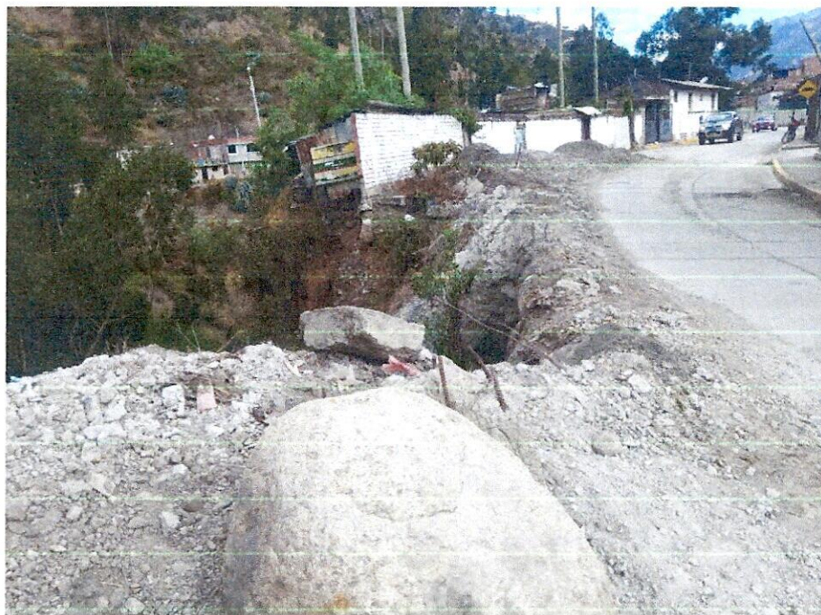
Fotografía 02: Se puede observar como toda la vereda construida y la baranda instalada con el proyecto ha desaparecido a causa del derrumbe del muro.
