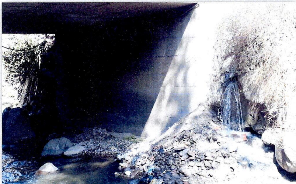
FOTOGRAFÍA N°03: Vertimiento de Aguas residuales sin tratar – río Carash
